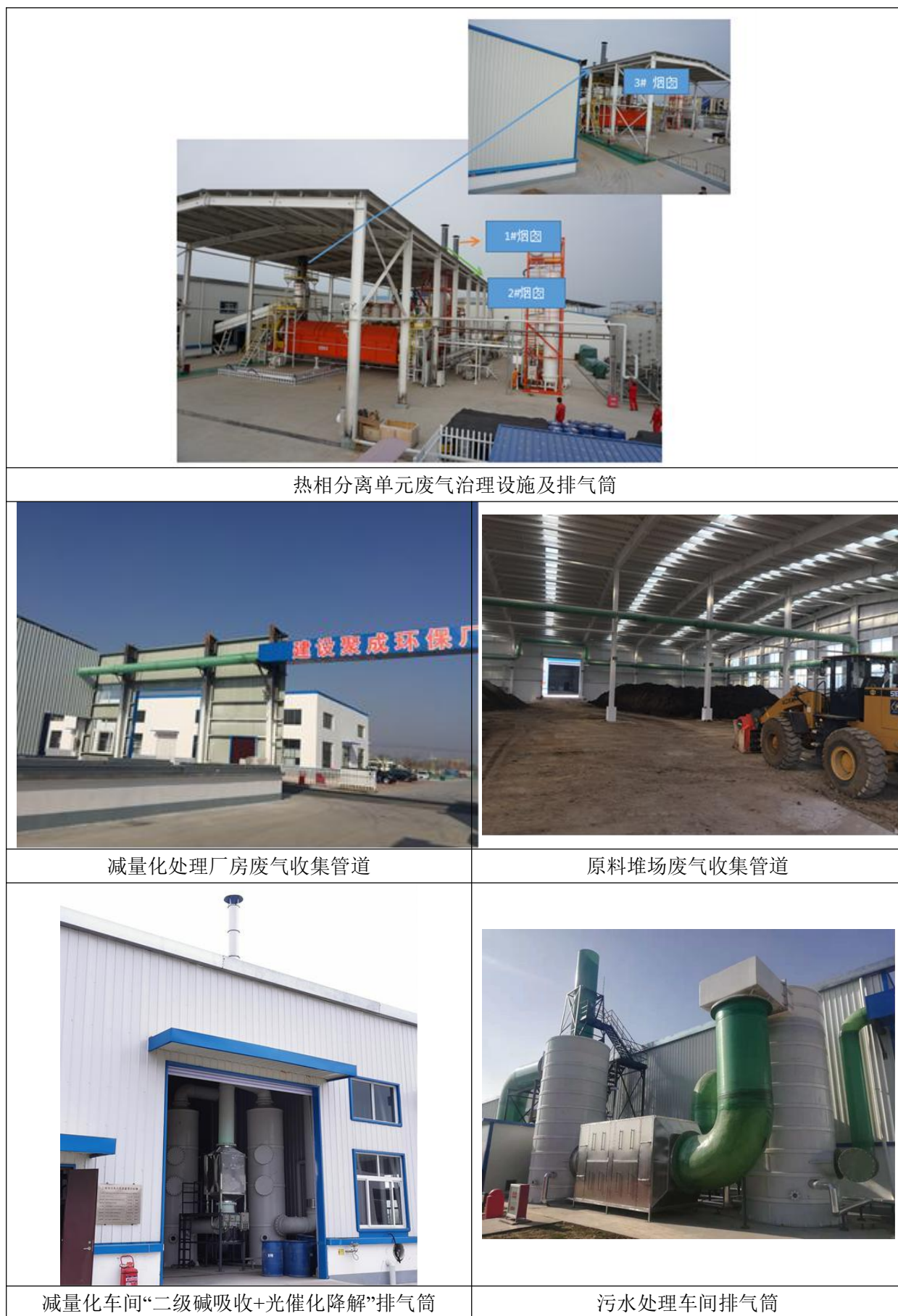
图2.7-1 废气处理设施
