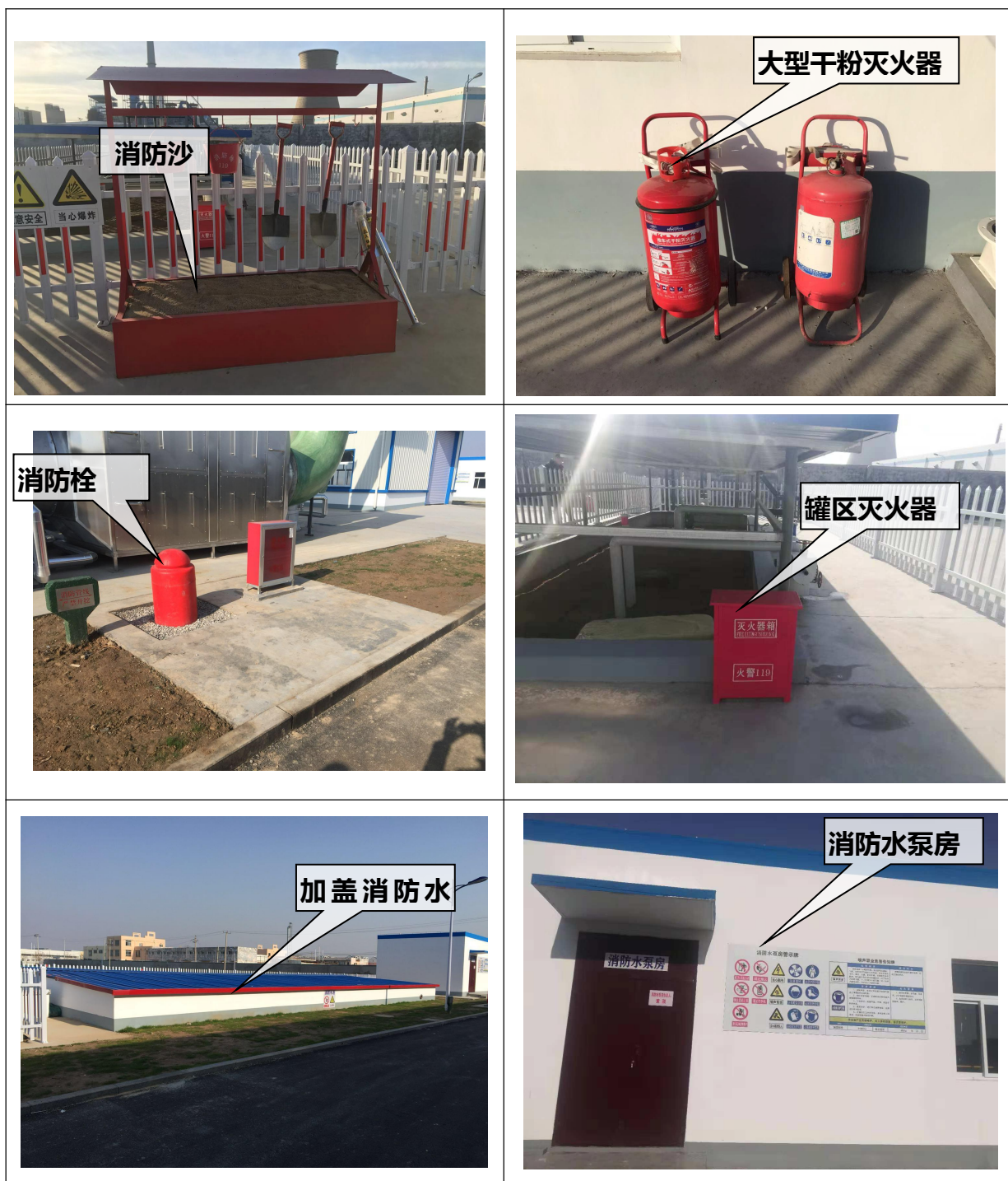
图2.7-6 消防设施设置情况
